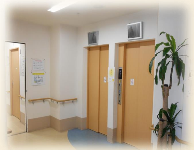
エ レ ベ ー タ ー
